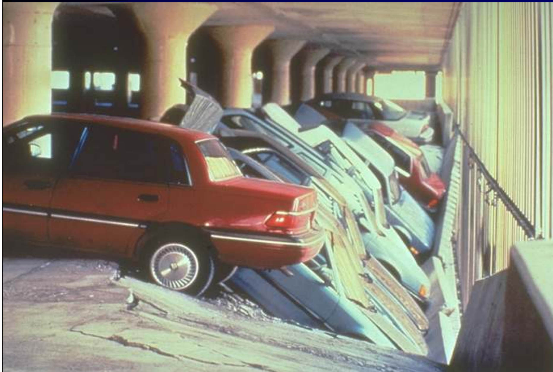
Korozja Podłogi Parkingu
