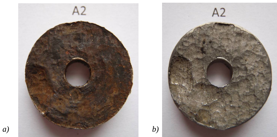
Rys. 2. Widok powierzchni wewnętrznej rurociągu DN1000 w miejscach montażu anod: a) przed oczyszczeniem; b) po usunięciu produktów korozji
