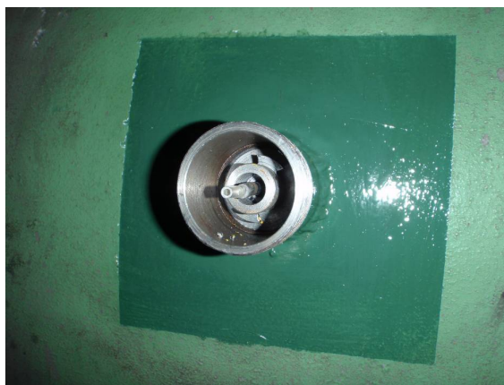
Rys. 4. Króciec z zamontowaną anodą
