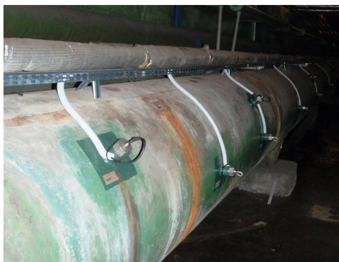
Rys. 7. Widok ogólny odcinka rurociągu z zamontowanymi anodami, elektrodami pomiarowymi i okablowaniem
