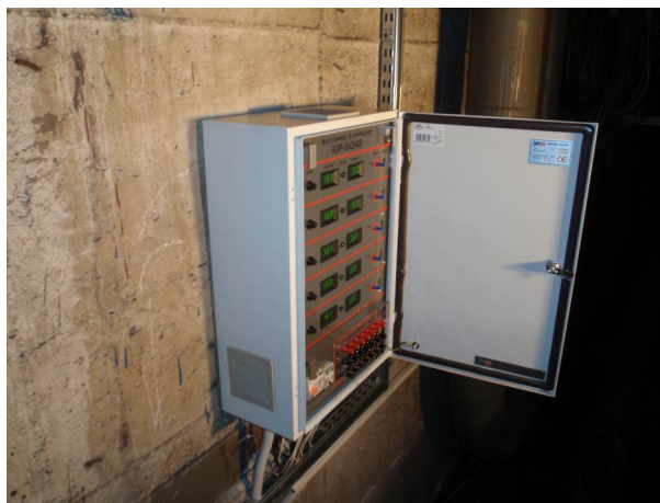
Rys. 8. Urządzenie polaryzujące IUP-5x2/48 zamontowane w kanale instalacyjnym
