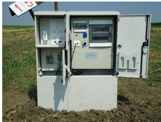
Fig. 5. CP Rectifier Station (TE-RCU)
