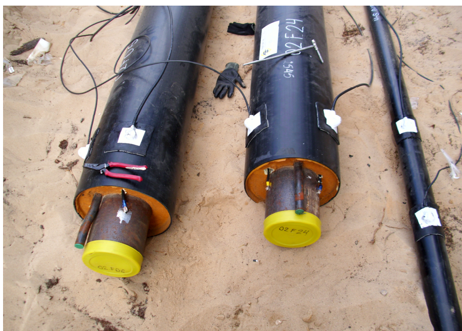
Rys. 7. Rury preizolowane – widoczne połączenia przewodów ochrony katodowej
