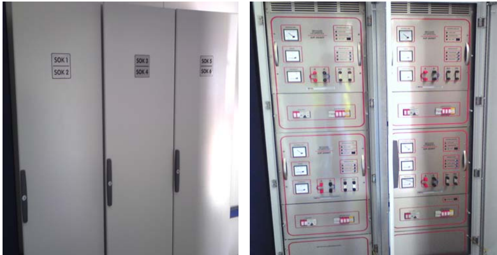
Rys. 4. Widok SOK zamontowanych w Ośrodku Centralnym
