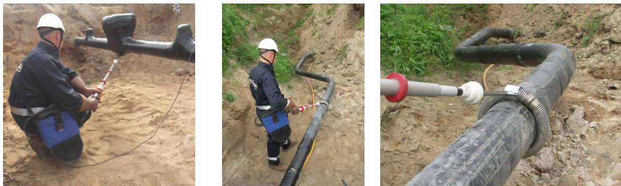
Rys. 1. Zbadanie powłoki izolacyjnej rurociągu poroskopem przed zasypaniem nie stanowi gwarancji, że po zasypaniu powłoka będzie szczelna
