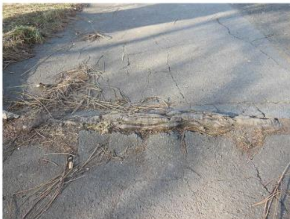
Miejsce znajdujące się bezpośrednio nad nitką instalacji powinno być wolne od drzew i krzewów o silnym systemie korzeniowym, który może zagrozić ciągłości tej instalacji. Zapewne wiesz jak silne i niszczyielskie potrafią być korzenie. Skoro mogą podważać asfalt, to "jakaś tam" rurka – nie będzie dla nich żadną przeszkodą.
