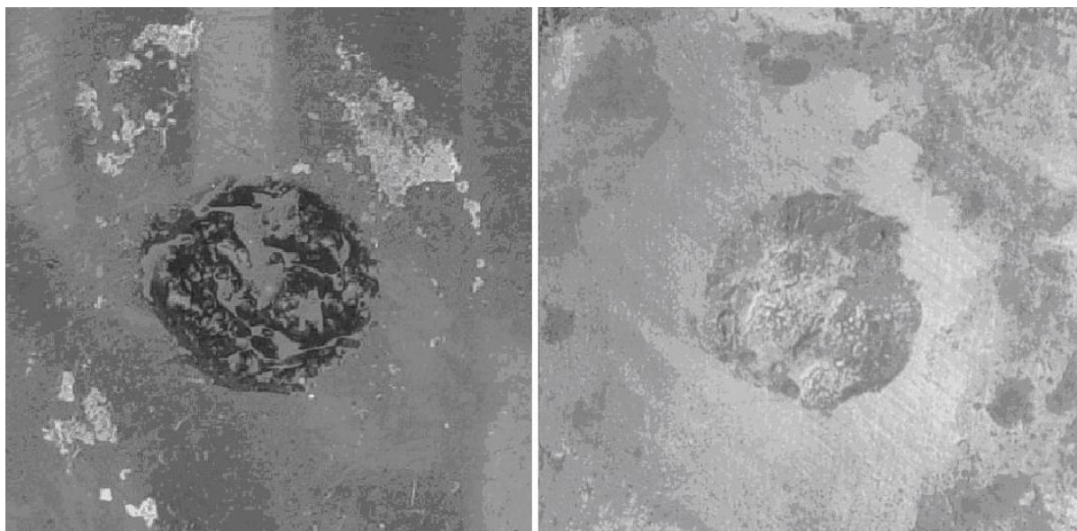
Rys.5. Korozja prądu przemiennego na elektrodzie symulującej 1\text{ cm}^2 po okresie dwuletniej ekspozycji w zagrożonym miejscu, z lewej - widok przed usunięciem osadów (Wzór nie jest głęboki, gdyż początkowa korozja prądu przemiennego została powstrzymana w wyniku wytworzenia się osadów katodowych)
