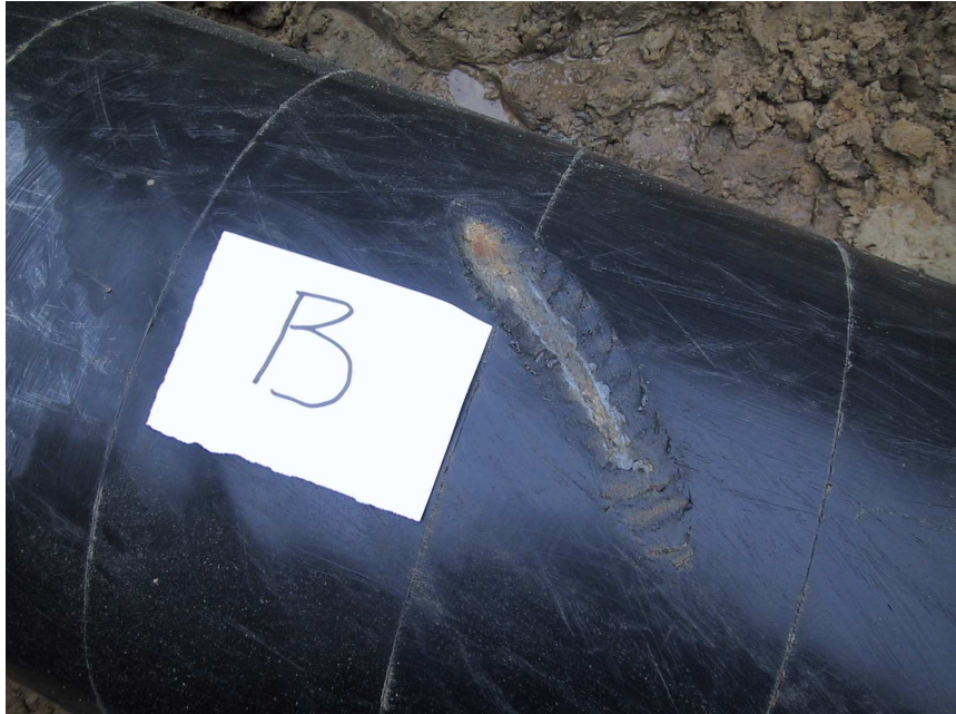
Rys. 11. Przykład uszkodzenia powłoki izolacyjnej gazociągu spowodowanego przez stronę trzecią. Moment powstania uszkodzenia zasygnalizowany został przez system zdalnego monitoringu (rys. 10); gazociąg pokryty powłoką PE o wysokim stopniu szczelności; miejsce uszkodzenia powłoki oddalone o 15 km od punktu monitorowania potencjału
